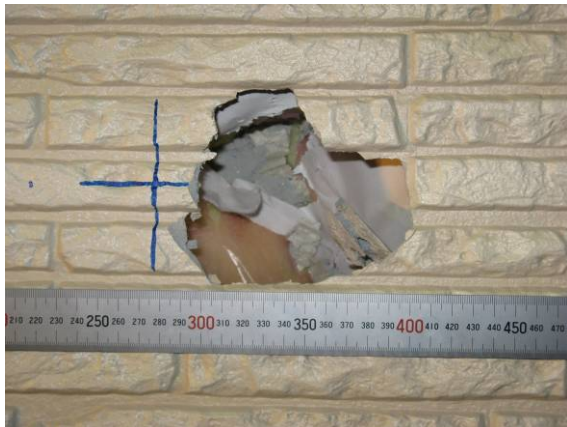
(5) ミサイル B によるパネルの破損 (試験体 No.2)
