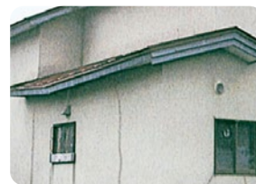
ひび割れ (モルタル壁のクラック)
